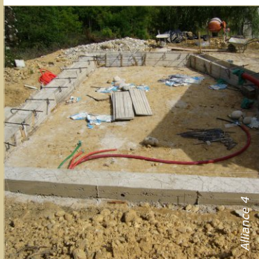
Fondations et soubassement sont réalisés dans la fouleée, ici pour une construction en bottes de paille.
