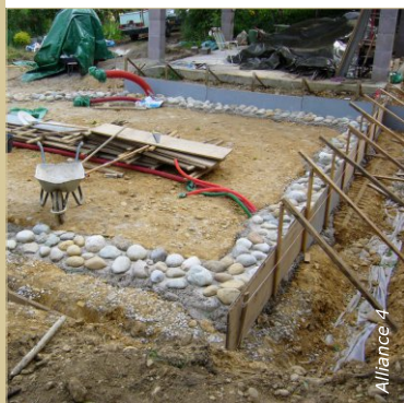
En terrain argileux, les fouilles sont suffisamment stables pour éviter de coffrer les fondations.
