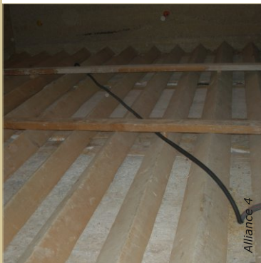
Le plancher à la provençale est monté sur des chevrons triangulaires, les câbrons. Leur forme est importante pour le maintien du béton de chanvre.
