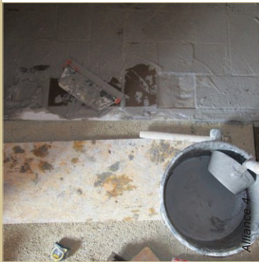
Les carreaux de terre cuite sont posés sur une chape en mortier de chaux.
