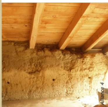
La jonction entre le haut du mur et la toiture est rebouchée avec du béton d'argile, des pierres et des adobes. Cette barrière maçonnée évite le passage du vent et des animaux.
