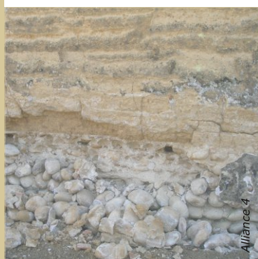
Soumis à des charges humides trop fortes depuis des années, une partie du soubassement s'est écroulé. Bloqué sous une plaque hydraulique et sous l'effet du gel, le mortier est devenu friable et les pierres se sont déchaussées.
