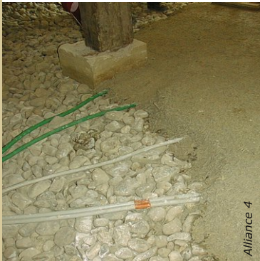
La dalle en matériau chaux et chanvre, sur hérisson de pierre ventilé, est l'un des postes clé d'une habitation bio-compatible.
